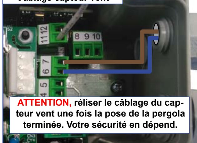
Câblage capteur vent
